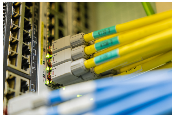
信頼性の高い日本製線の Cat.6A ケーブリング
