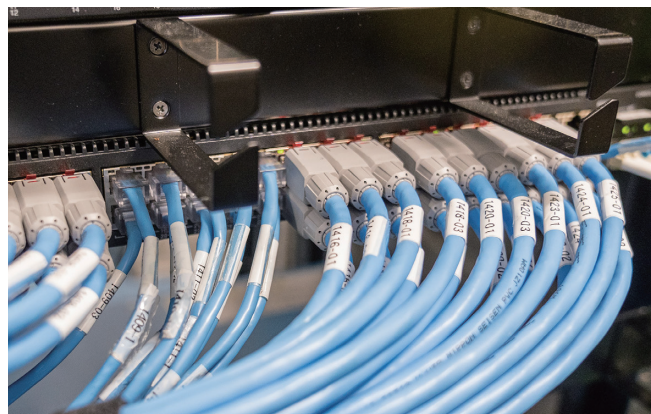
実際に敷設された Cat.6A ケーブル
